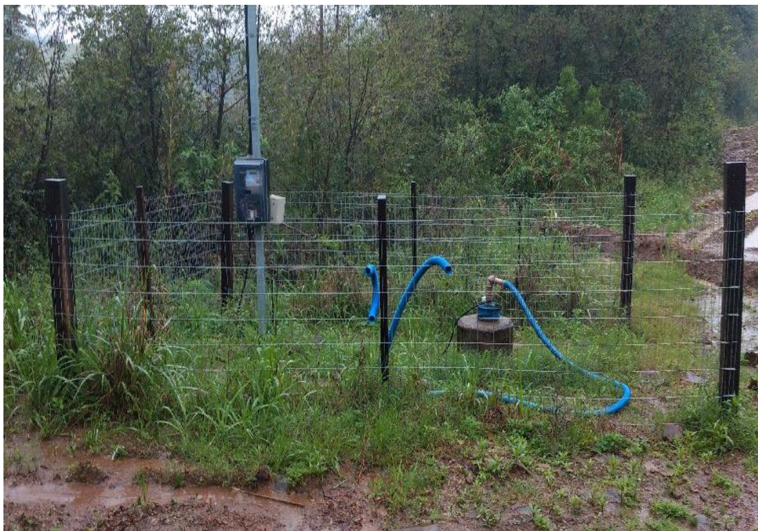
Figura 38 – P9: Poço que abastece Cerro Seco (Zona Rural)
