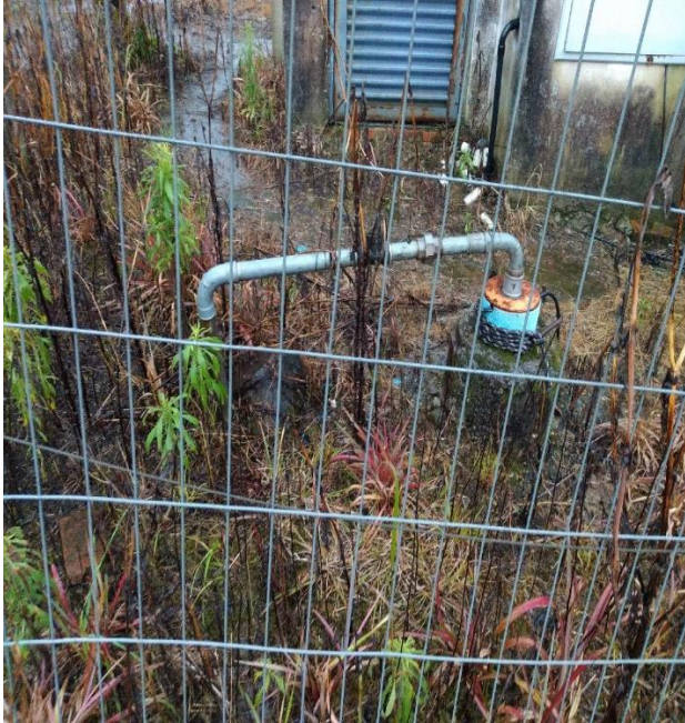
Figura 46 – P12 : Localização do poço na Sociedade de água Linha Somavilla (Zona rural)
