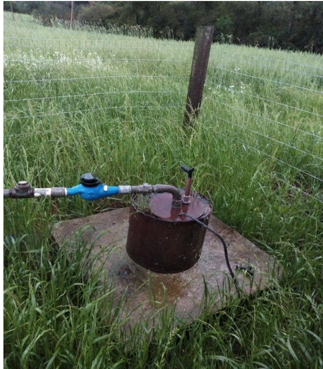
Figura 53 – P15 : Localização do poço na Sociedade de Água Linha das bicas (Zona Rural)
