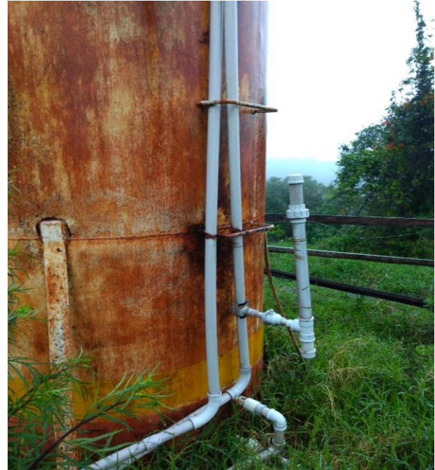
Figura 41 – Dosador de cloro tipo pastilha acoplado ao reservatório - Itaúba (Zona urbana)
