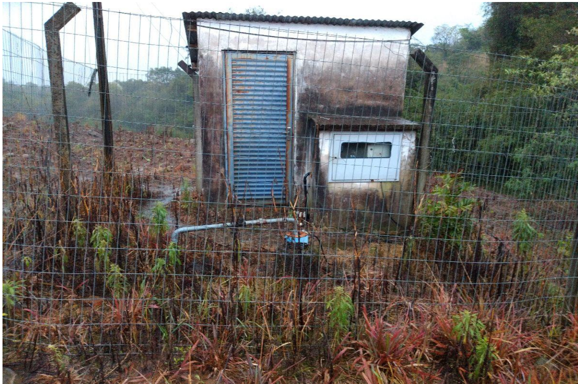
Figura 48 – Casa de química desativada localizado na Sociedade de Água Linha Somavilla
