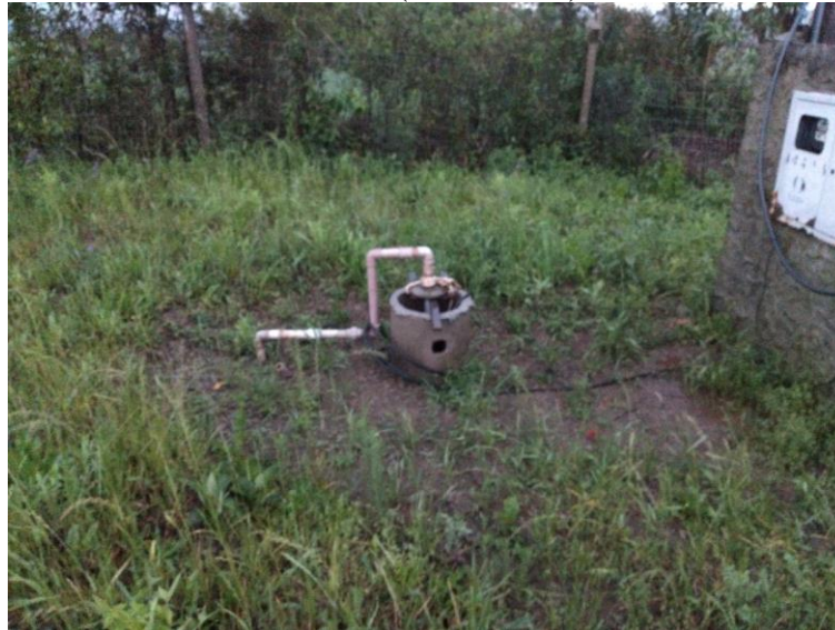
Figura 55 – P16 : Localização do poço na Sociedade de Água Rincão da Estrela – Poço Dinaldo (Zona Rural)
