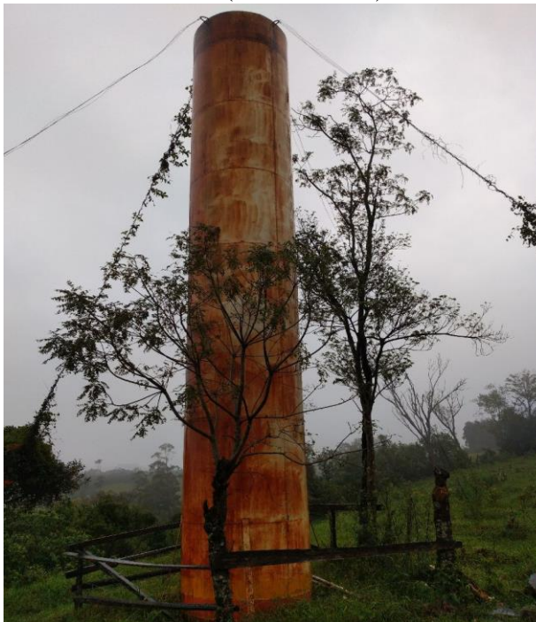
Figura 42 – Reservatório (25m 3 ) de água Itaúba (Zona urbana)
