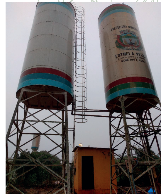
Reservatório zona urbana (poço da fazenda)
