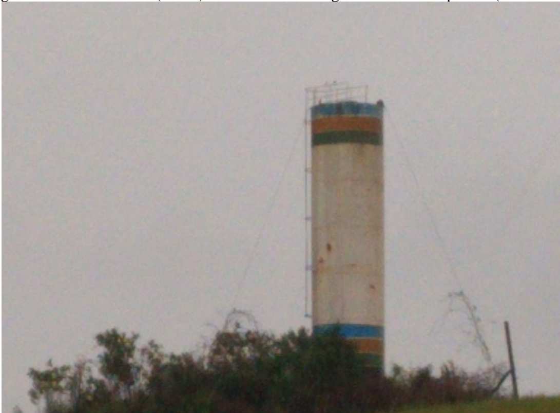
Figura 32 – Reservatório (30 m 3 ) da Sociedade de Água Rincão do Espinilio (Zona Rural)
