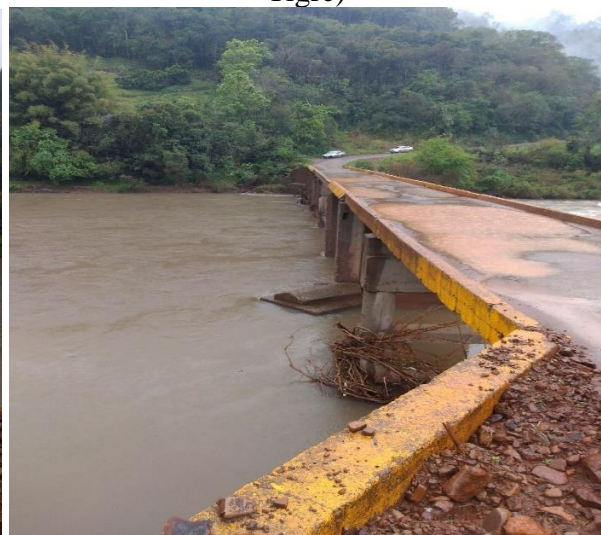
Figura 14 – Ponte sobre o Rio Jacuizinho no município de Estrela Velha/RS (acesso do Distrito de Itaúba ao município de Arroio do Tigre)
