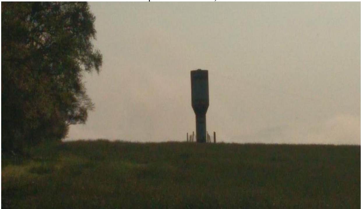
Figura 37 – Reservatório de água na Sociedade de água Santa Terezinha (Metálico com capacidade de 20m 3 )
