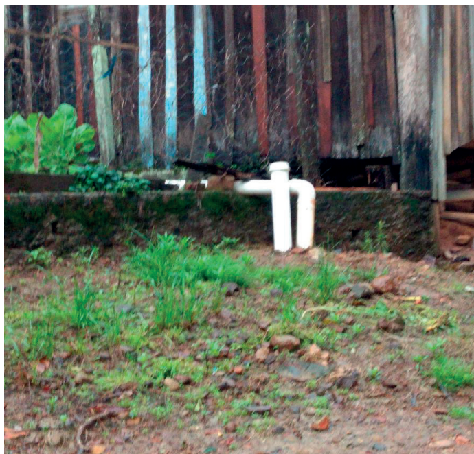
Tubulação superficial de esgotamento sanitário em residência na zona rural
