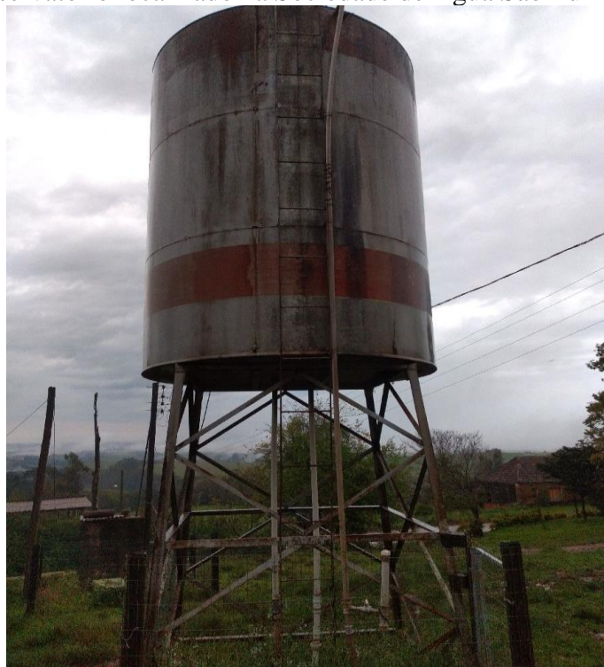
Figura 52 – Reservatório localizado na Sociedade de Água São Luiz (metal de 20m 3 )
