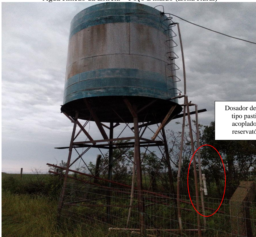
Figura 56 – Reservatório (metálico de 20m 3 ) localizado na Sociedade de Água Sociedade de Água Rincão da Estrela – Poço Dinaldo (Zona Rural)
