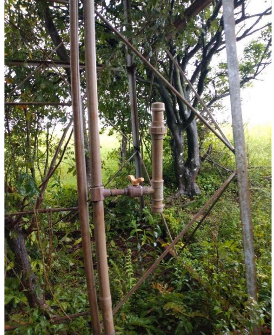
Figura 34 – Dosador de cloro tipo pastilha acoplado ao reservatório - Rincão São Luiz – Linha Limberger (Zona Rural)
