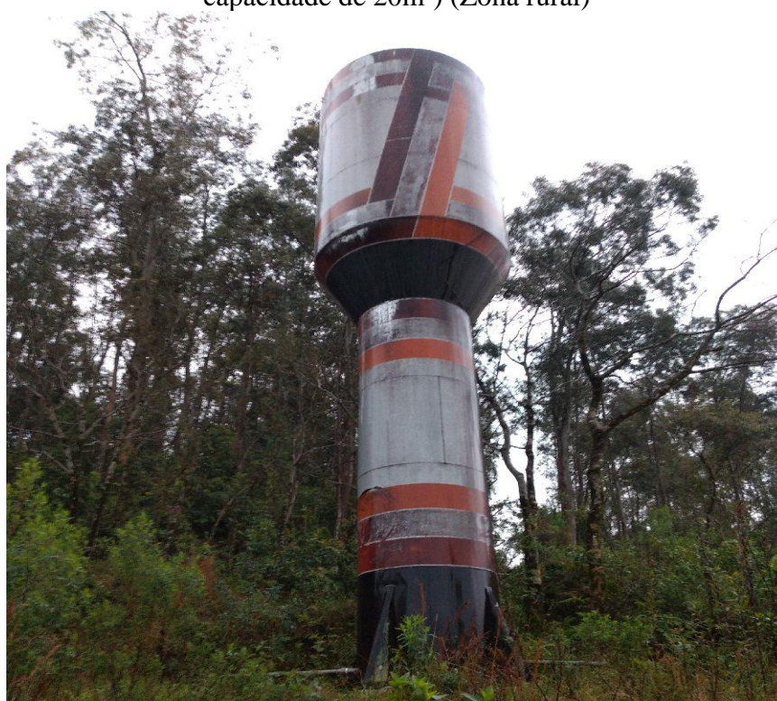
Figura 45 – Reservatório localizado na Sociedade de água Linha Dalcin (metálico com capacidade de 20m 3 ) (Zona rural)
