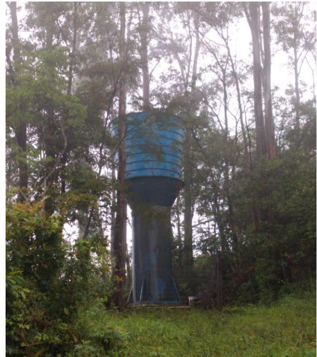
Figura 43 – Reservatório (15 m 3 ) de água Itaúba (Zona urbana)
