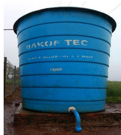
Figura 25 – Reservatório ativo (15m 3 ) - Sede RST-481 Poço da Fazenda (Zona urbana)
